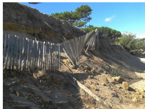
Illustration 47 – Photographies prises dans le cadre du ROL en 2013 montrant l'érosion marquée du haut de la plage de Calvi
